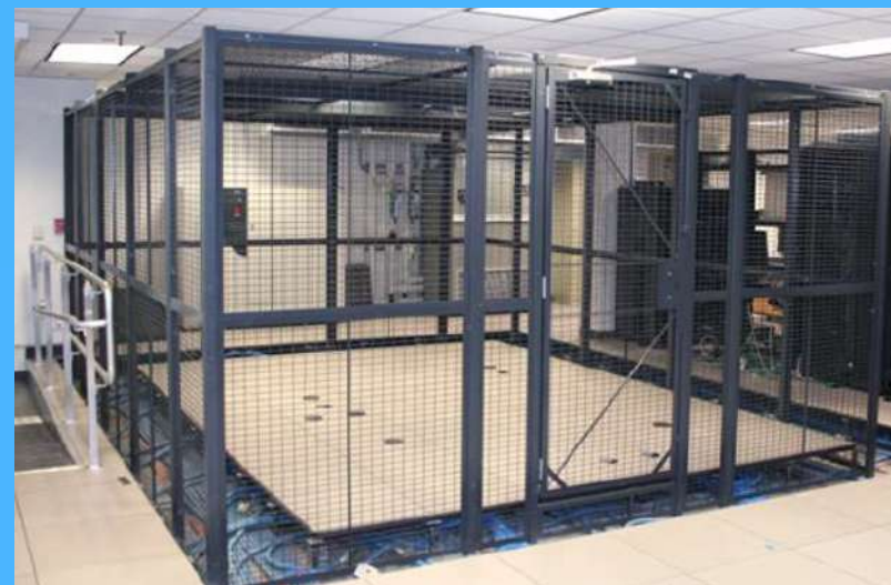
Cage de sécurité dans le centre de données
